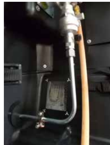
Frappe à froid via fenêtre dans coffre à gaz avant droit.
