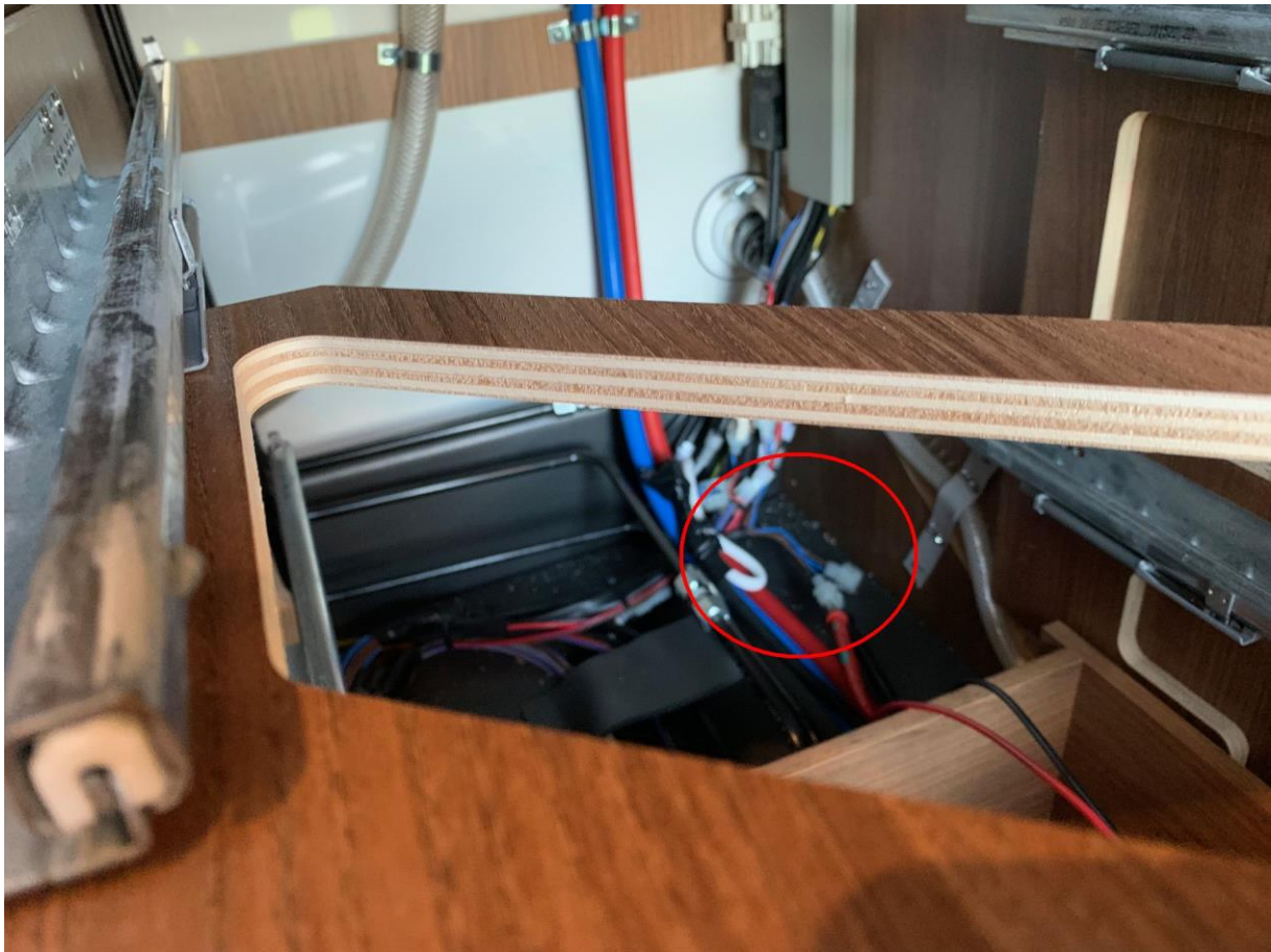
Bild 1: Schubladen herausgenommen, Blick auf den Kabelsalat mit den beiden freien 12V Anschlüssen
